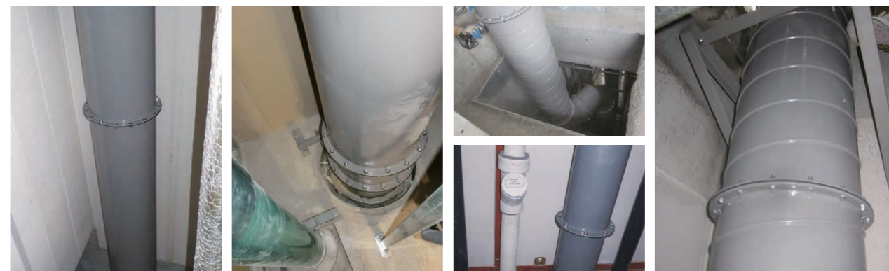
都内某所物件配管写真
